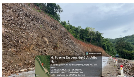
Hình 8. Điểm trượt lở trên tuyến đường giao thông vào Thủy điện Bản Vẽ thuộc xã Lượng Minh - huyện Tương Dương tháng 8/2023
